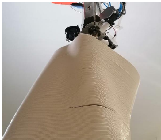
Figura 101 Fissura durante a produção da peça
