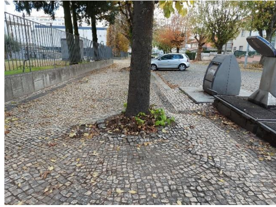
Figura 65 - Afloração de raízes no passeio da Rua da Restauração
