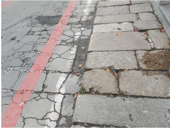
Figura 64 - Passeio com pavimento inadequado na Rua Dom Pedro V
