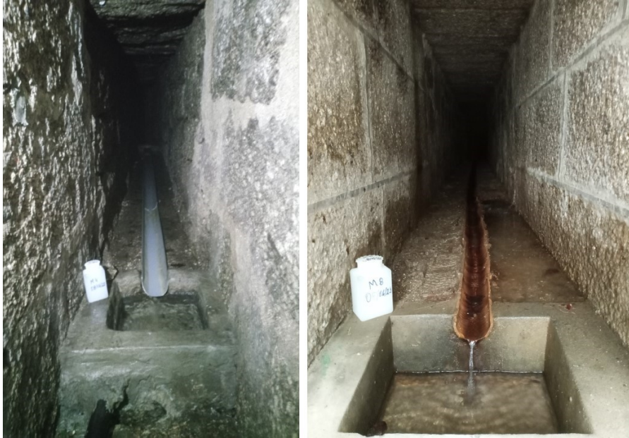
Figura 35- Exemplo de galerias por onde a água do sistema de minas de água da Montanha da Penha circula (mina 4 na esquerda e mina 8 na direita).
