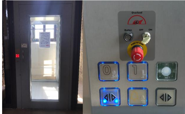
Figura 62 - O elevador do Castello di Desenzano
