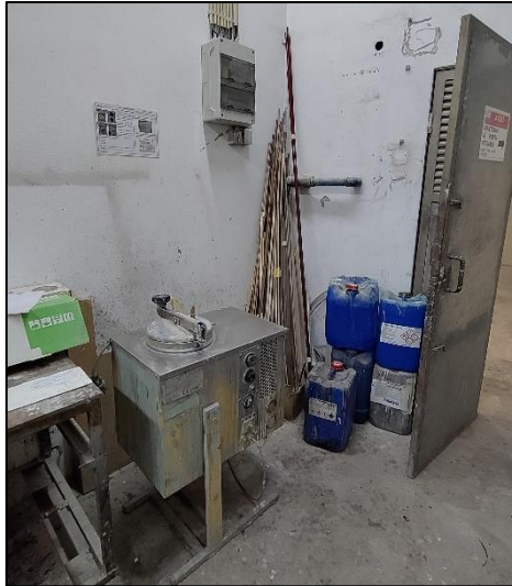
Figura 32- Registo fotográfico do local inapropriado para a regeneração de solventes
