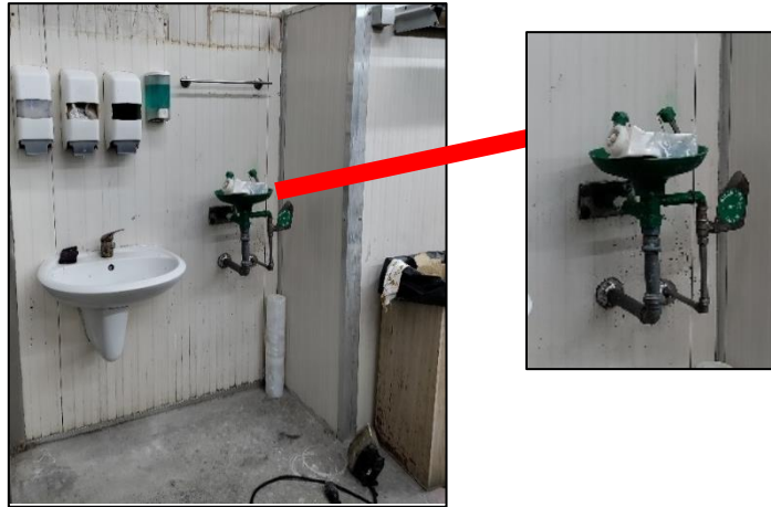
Figura 28- Registo fotográfico da zona de lavatório e lava-olhos
