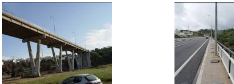
Figura 7 – Ponte ensaiada localizada em Tavira e vista da berma onde foram efectuados os ensaios.
