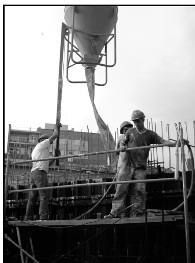
Figura 4 – Betonagem de elemento vertical (parede resistente) com auxílio de andaime e utilizando balde de grua torre.
