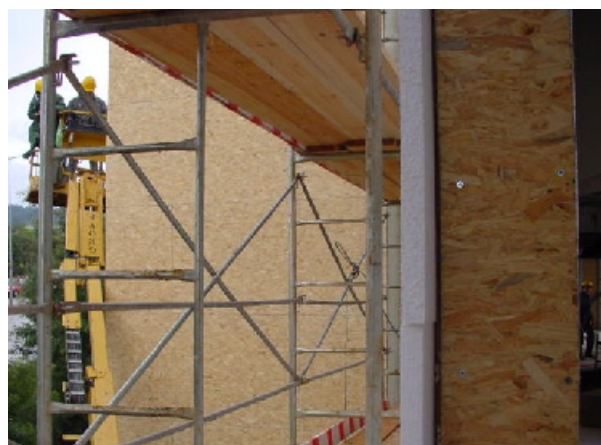
Figura 9.12 – Aspecto da face exterior de uma parede com estrutura de perfis metálicos leves, em fase de construção – durante a fixação do EPS às placas OSB
