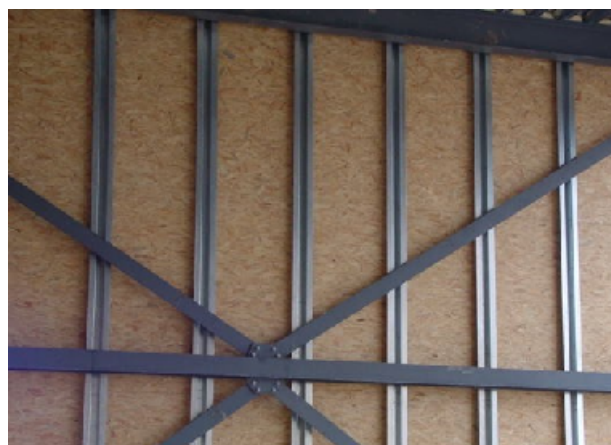
Figura 9.11 – Aspecto do interior de uma parede com estrutura de perfis metálicos leves, em fase de construção – antes da colocação da lã de rocha e da execução do revestimento interior
