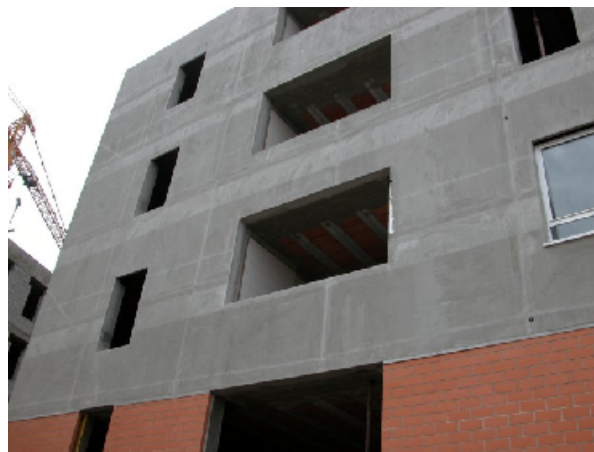
Figura 9.5 – Aspecto de uma parede simples com reboco armado, sobre isolante contínuo pelo exterior, após a execução do reboco
