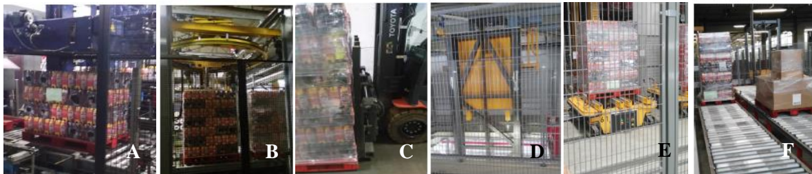
Figura 5.16. Circuito de passagem. A - Paletizadora. B - Envolvedora. C - Empilhador. D - Elevador. E- Monotrail. F – Pistas gravíticas.
