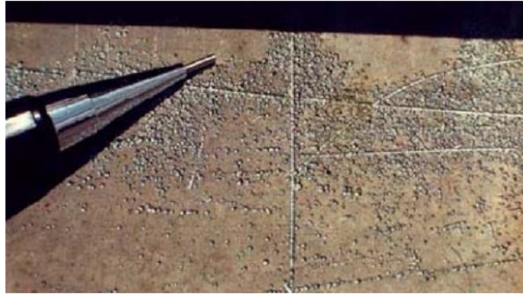
Figura 2.9 - Corrosão por picadas [23].
