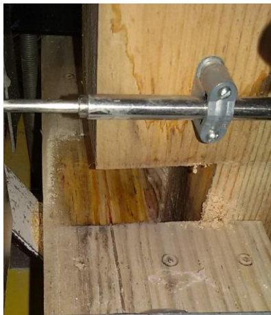
Figura 5.18 – Fotografia da parte interior de uma ligação envelhecida.
