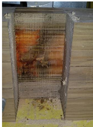
Figura 5.10 - Fotografia do interior da viga de uma ligação envelhecida.
