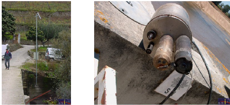
Figura 5.9: Esquerda: Estação hidro-qualidade automática, de dezembro de 2003, em Ermida-Corgo (DSRH/INAG). Direita: Sonda de Qualidade da Água e de nível danificada (DSRH/INAG).
