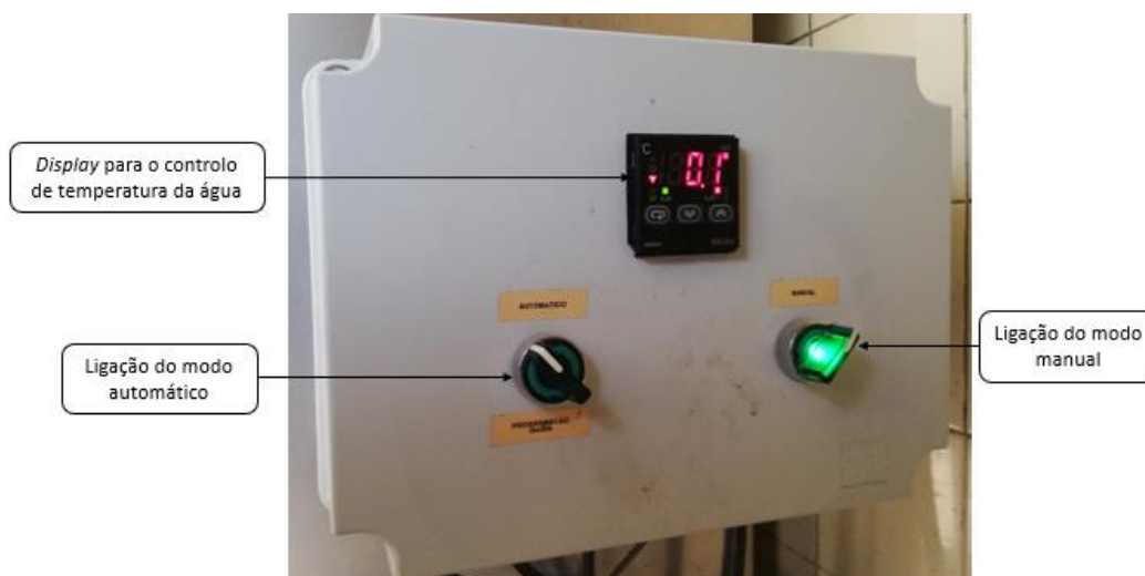
Figura 30 - Quadro elétrico da câmara de humificação 1.
