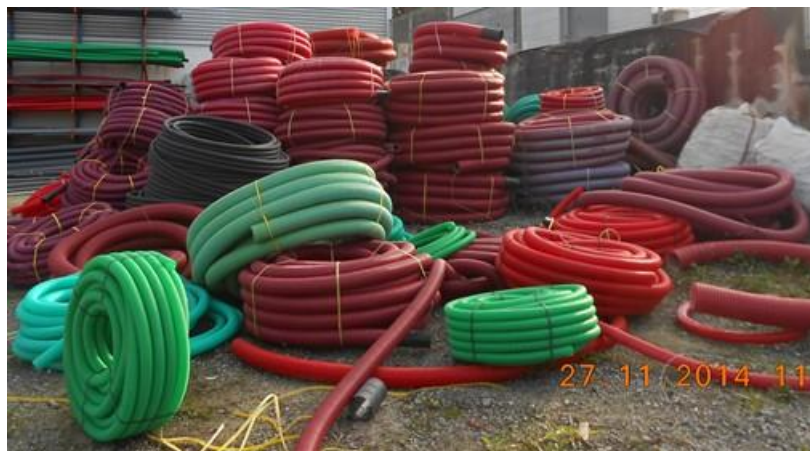
Figura 17 – Material operacional misturado com material obsoleto no Estaleiro
