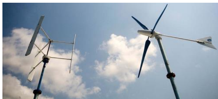
Figura 12 - Micro geradores eólicos, o primeiro com turbina de eixo vertical e o segundo com turbina de eixo horizontal [16].
