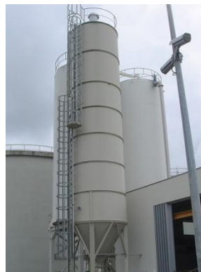
Figura 11. Fotografia dos Silos de lamas e do armazenamento de cal viva da ETAR do Ave.
