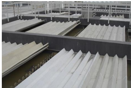
Figura 7. Fotografia dos Decantadores Primários da ETAR do vale do Ave.
