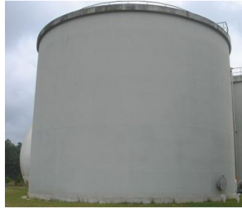
Figura 12. Fotografia de um dos digestores anaeróbios da ETAR do Ave.
