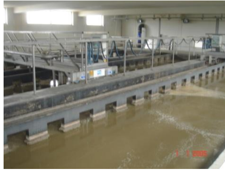
Figura 6. Fotografia da remoção de areias e gorduras da ETAR do Ave.
