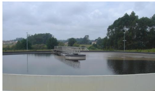
Figura 9. Fotografia da decantação secundária da ETAR do Ave.
