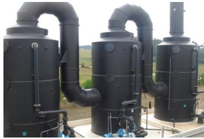
Figura 14. Fotografia dos ventiladores da desodorização da ETAR do Ave.
