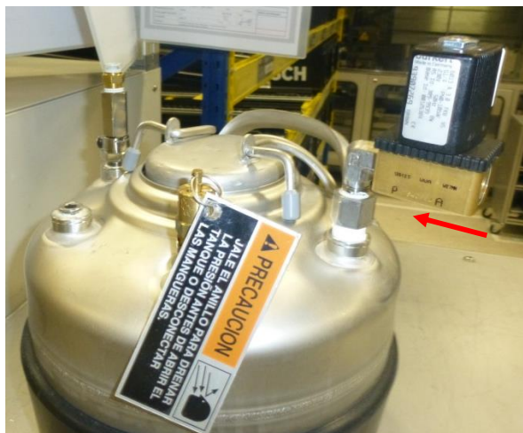
Figura 68 – Instalação da electroválvula
