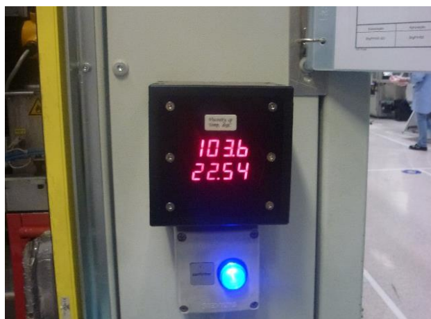
Figura 66 – Instalação do controlador no equipamento
