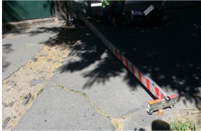
Figura 90 - Zona irregular a nível transversal devido a degradação no trecho
