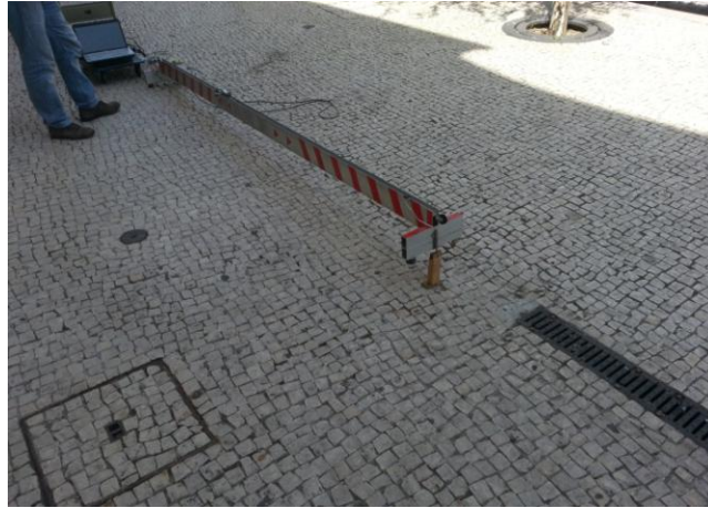
Figura 79 - Diferença nas inclinações e existência de dispositivos de escoamento
