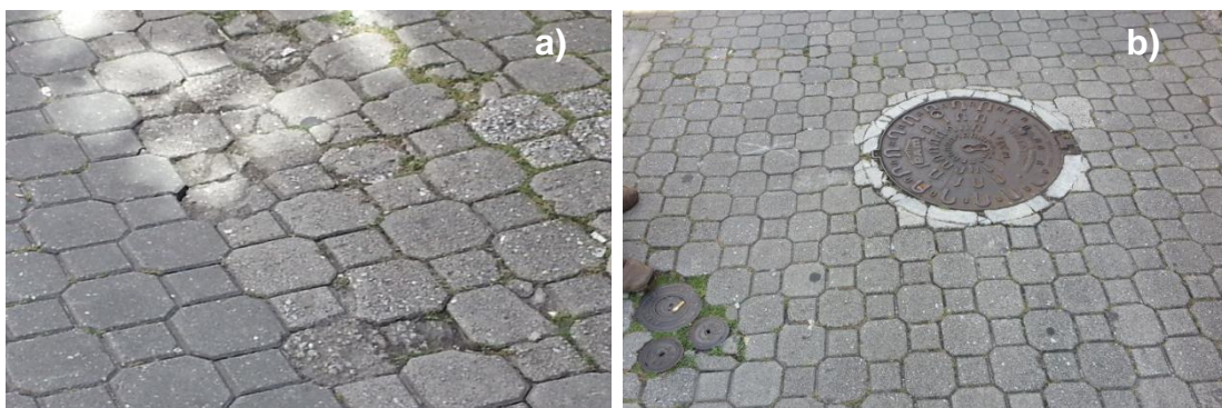
Figura 59 - a) Diferença na textura dos blocos de betão e b) Condições de pavimentação junto às tampas de saneamento
