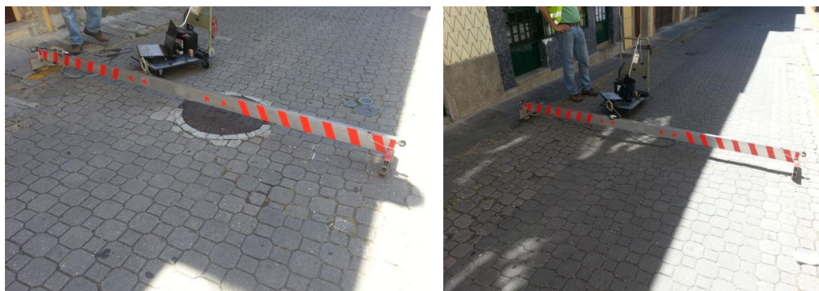
Figura 98 - Zonas irregulares devido a degradação e presença de tampas de águas pluviais
