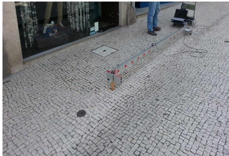
Figura 78 - Diferença de inclinação no trecho em cubos de calcário
