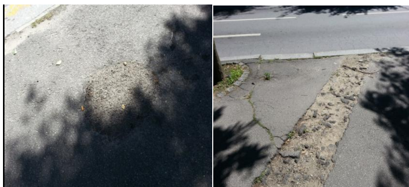
Figura 26 - Degradações no trecho em betuminoso (Braga)
