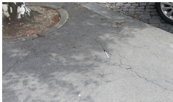
Figura 23 - Fissuras no passeio junto às árvores
