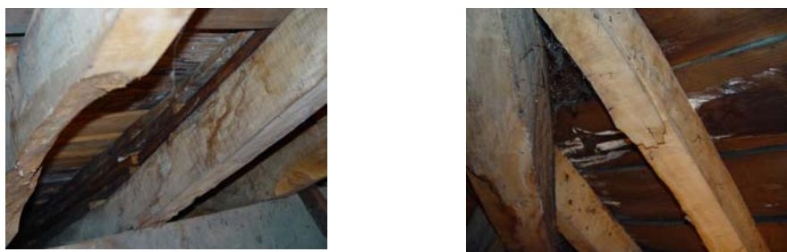
Figura 5 – Efeito da humidade nos elementos do forro. As manchas de humidade e a presença de fungos de podridão indiciam infiltrações antigas.
