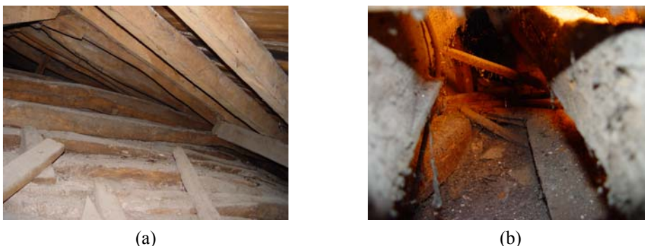
Figura 8 – Resíduos observados sobre as madeiras do fasquiado: (a) aspecto geral; (b) pormenor da zona central da cobertura.
