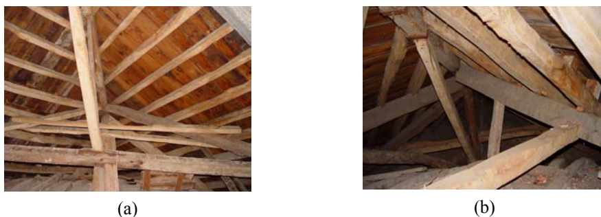
Figura 3 – Aspectos da cobertura: (a) vista geral, obtida a partir de uma abóbada secundária; (b) pormenor do madeiramento obtido no centro da abóbada central, com elementos estruturais principais.
