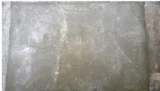
Figura 22: Argamassa fissurada de cimento com 40% de PCM e 0,5% fibras.
