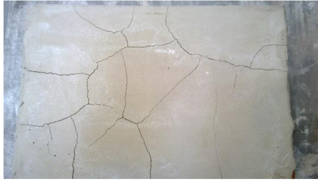
Figura 21: Argamassa fissurada de cal hidráulica com 40% de PCM e 0% de Fibras.
