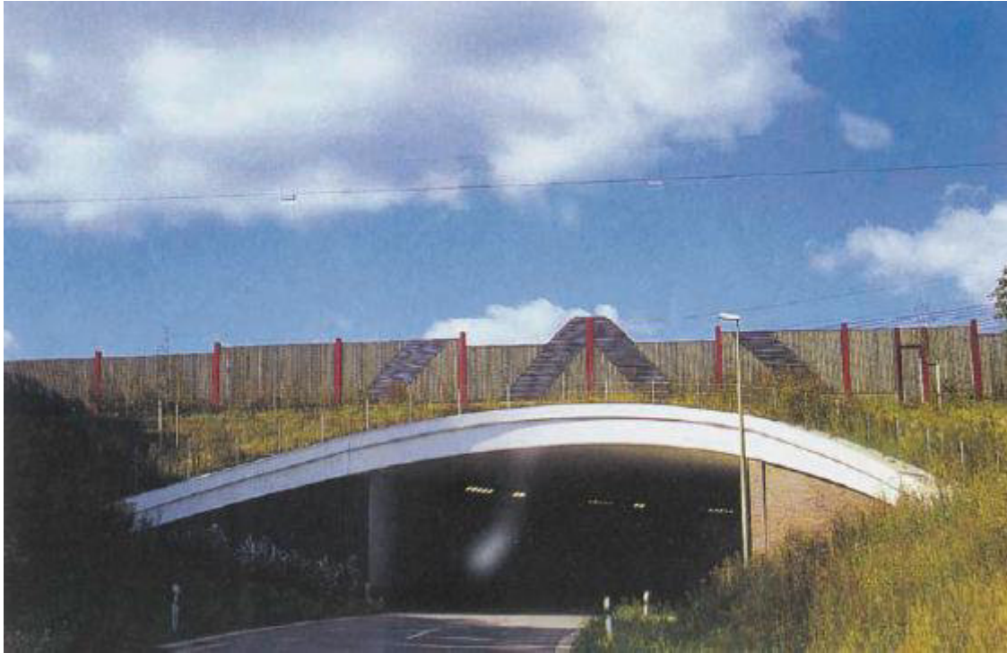
Figura 5.3 - Exemplo da incompatibilidade entre a madeira e o betão em viadutos e pontes, [27]
