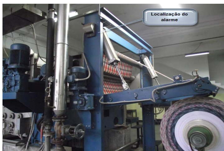
Figura V.8 – Máquina de mercerizar: localização do alarme utilizado.
