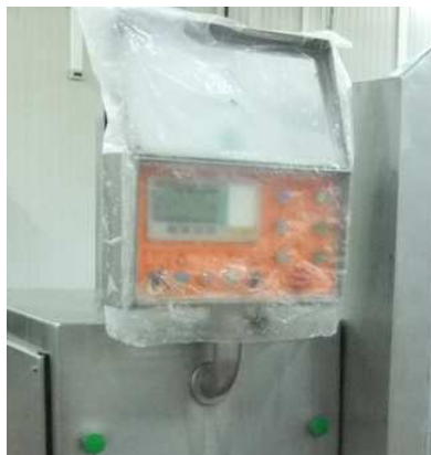
Fig. 3. 25 - Isolamento eficaz dos painéis elétricos - Misturadora 2.
