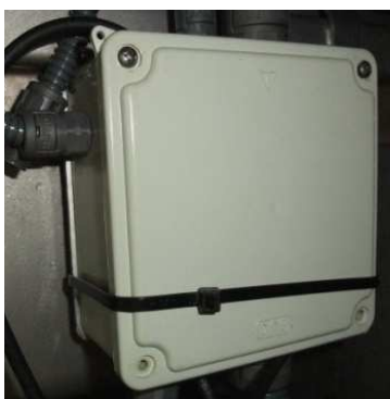
Fig. 3. 24 - Falta de aperto das caixas elétricas - Injetora.
