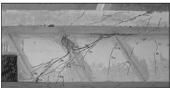
f) Após a marcação das fendas (pós ensaio)
