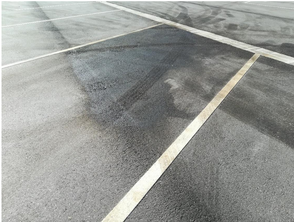
Figura 10 – Efeito da aplicação de esforços de torção com veículos pesados num local onde ocorreu um derrame de óleo no pavimento
