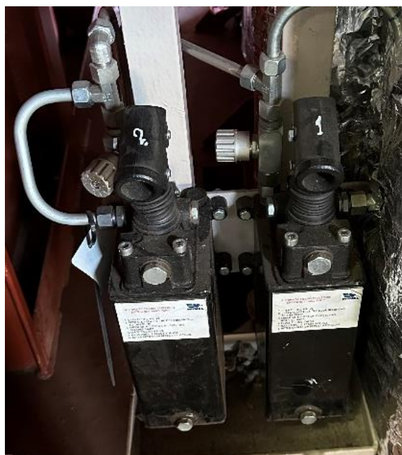
Figura 4: Mecanismo para acionamento manual das portas estanques.
