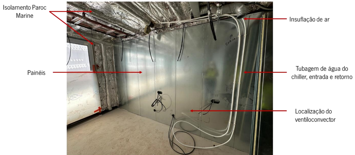
Figura 20: Aspeto de uma cabine em fase de construção onde é possível observar a localização de elementos construtivos e componentes do sistema AVAC numa cabine de passageiros do main deck .
