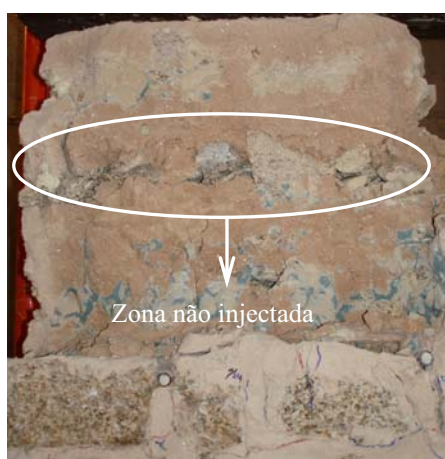
Figura 5.28 – Zona não injectada do pano interno da parede 3W3.
