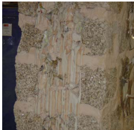
Figura 5.8 – Escorrimento de calda de injeção através da face transversal de uma parede reforçada com pregagens transversais.
