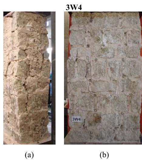
Figura C.10 – Padrão de fendilhação da parede 3W4 no final do ensaio: (a) face A; (b) face B.
