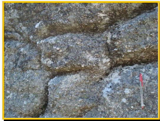
Fracturas poligonais (tipo côdea de pão).
