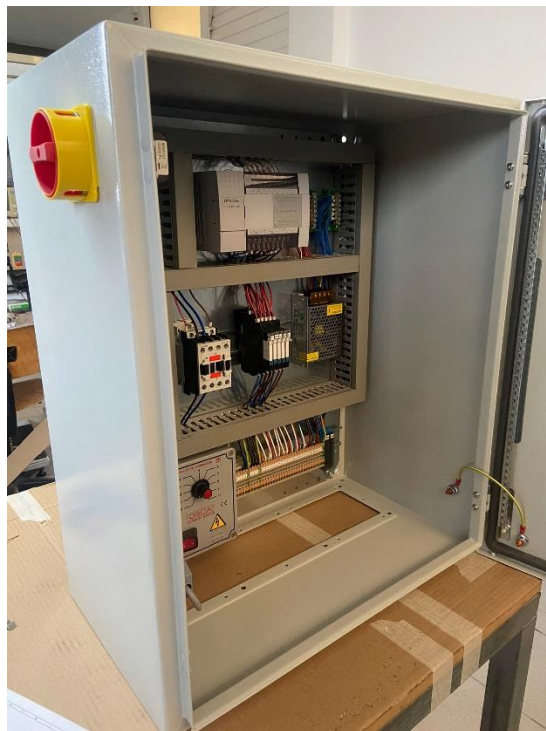
Figura 120 - Corte geral de energia no quadro elétrico
