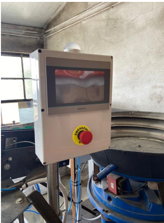
Figura 112 - Emergência painel da consola
