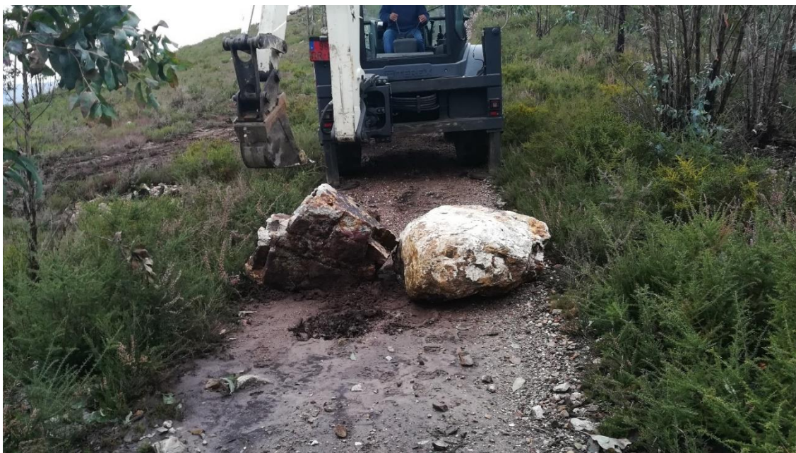
Figura 20 - Acompanhamento dos trabalhos de colocação de pedras de grande porte para bloqueio do lado oeste do monumento megalítico (autor).
