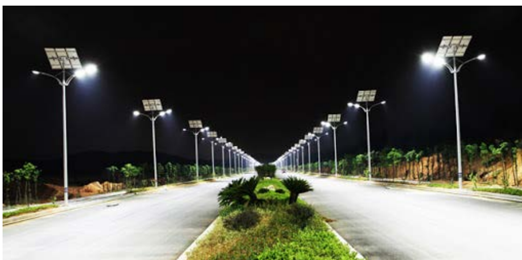
Figura 4 - Iluminação pública com LED e painel solar fotovoltaico Fonte: www.truelite.us/solar-led-street-lights-dubai-usa
