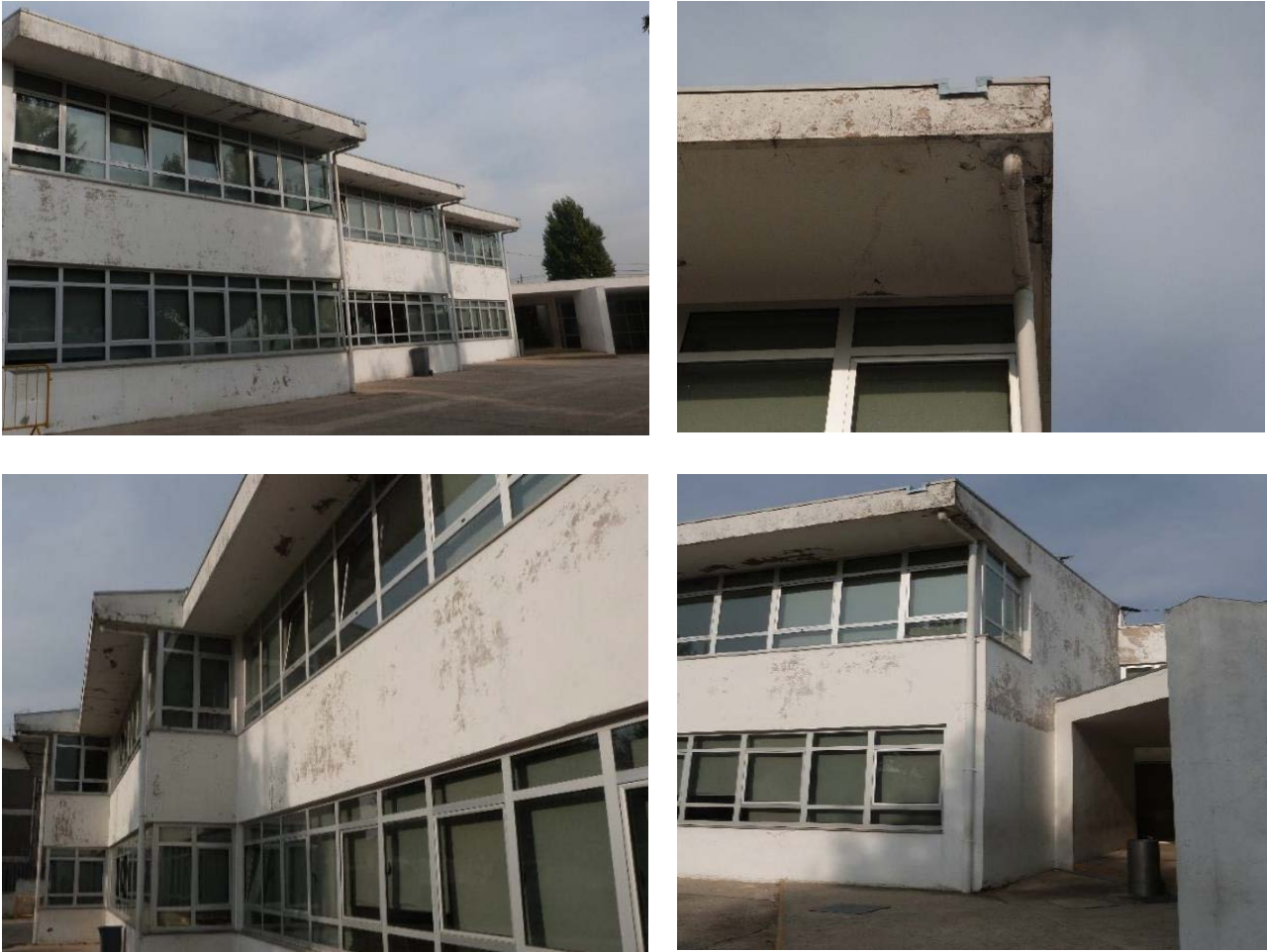
Figura 21 - Edifício do 1º ciclo da Escola Básica das Enguardas - antes da intervenção BUILD Fonte: Machado (2019a)
