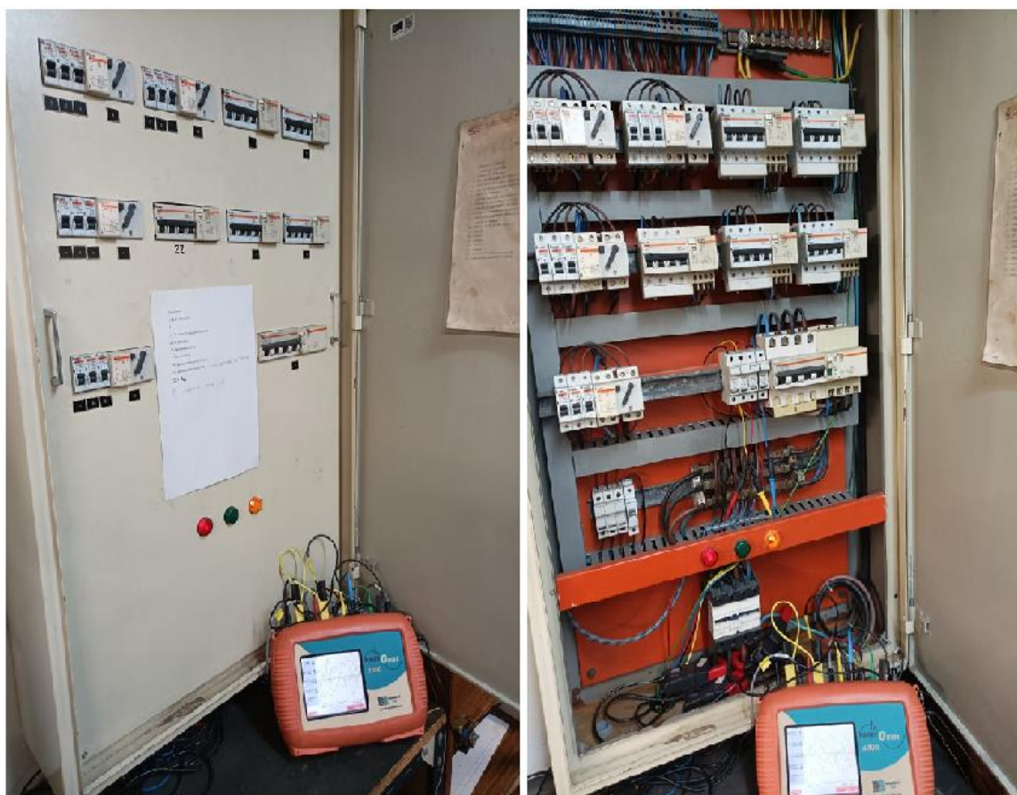
Figura 4.1 – Montagem do monitorizador no quadro elétrico.
