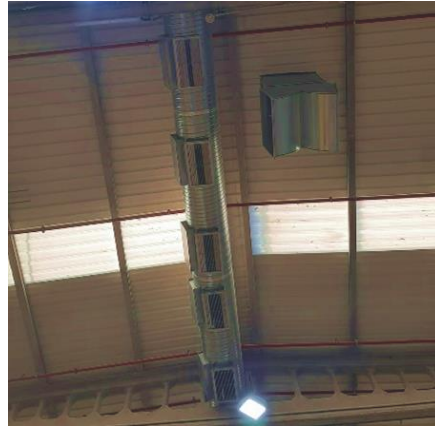
Figura 90 - Sistema de ventilação atual
