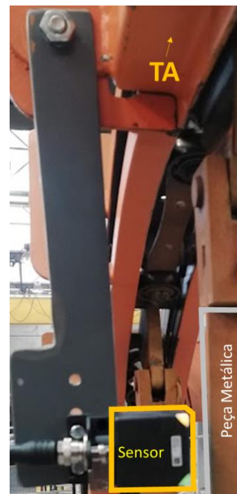
Figura 4.21 - Instalação do sensor indutivo no TA
