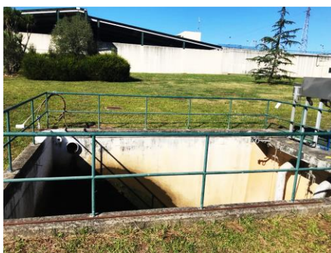
Figura 12. Estação Elevatória de lamas.
