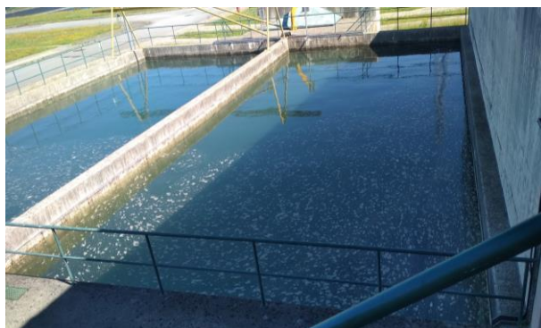
Figura 11. Cisterna de água de lavagem dos filtros.
