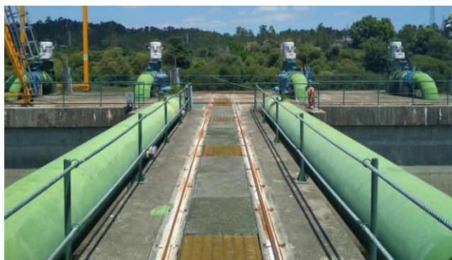
Figura 4. Estação Elevatória 01 (EE01).
