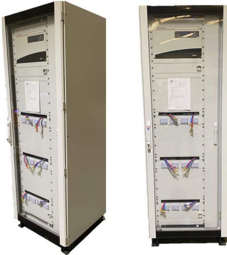
Figura 13 - Armário de Controlo
