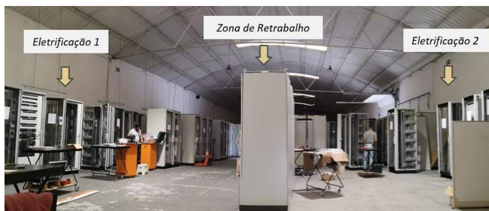
Figura 30 - Visão geral do setor de eletrificação
