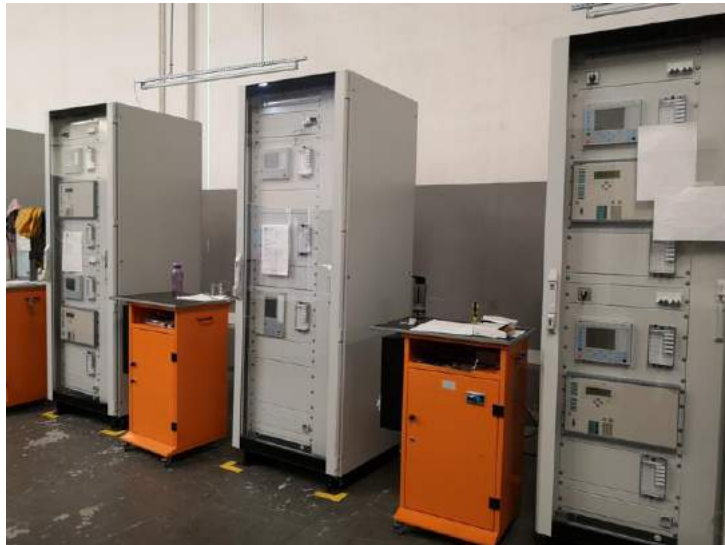
Figura 69 - Armários dispostos em fila no novo Setor de Eletrificação
