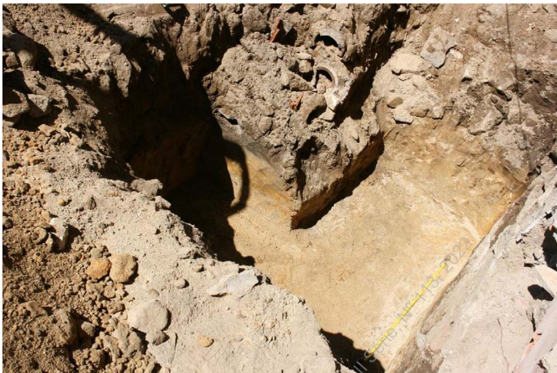
Foto 27 - (IMG_5381) – Aspeto de vala para implantação de sapata zona norte, aproximadamente ao centro do edifício, sendo visíveis os dois tubos de saneamento.
