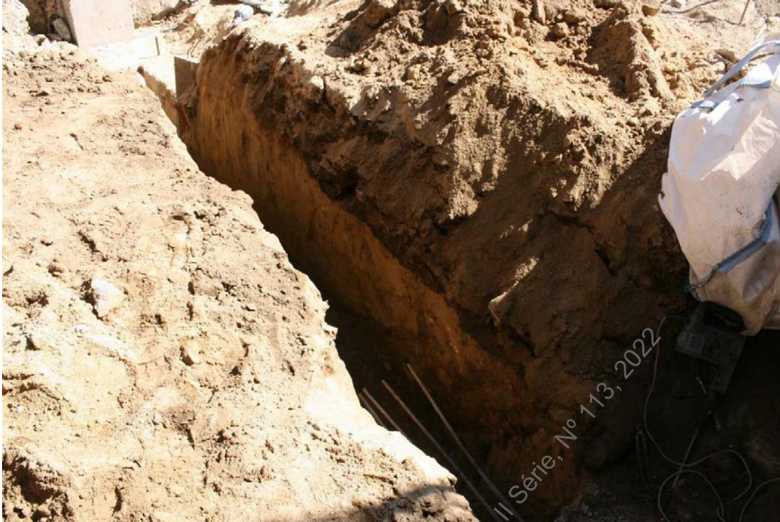
Foto 31 - (IMG_5610) – Aspeto vala entre sapata de escadas e empedrado, aproximadamente ao centro do edifício.
