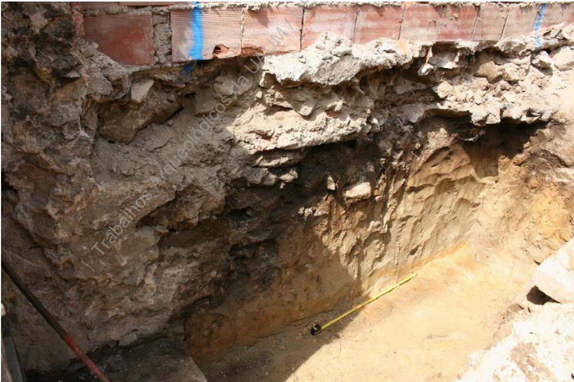
Foto 37 - (IMG_5476) – Aspeto vala para sapata com a mesma posição relativa da que está representada na foto 33, mas na zona norte do edifício.
