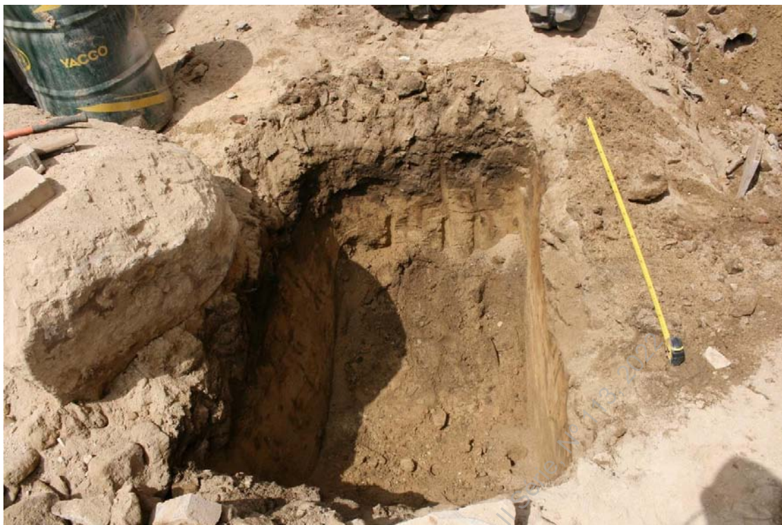
Foto 38 - (IMG_5298) – Aspeto de vala aberta na zona central, junto a sapatas visíveis nas fotos 34 e 36, sendo perceptível a ausência de elementos identificados nas mesmas.
