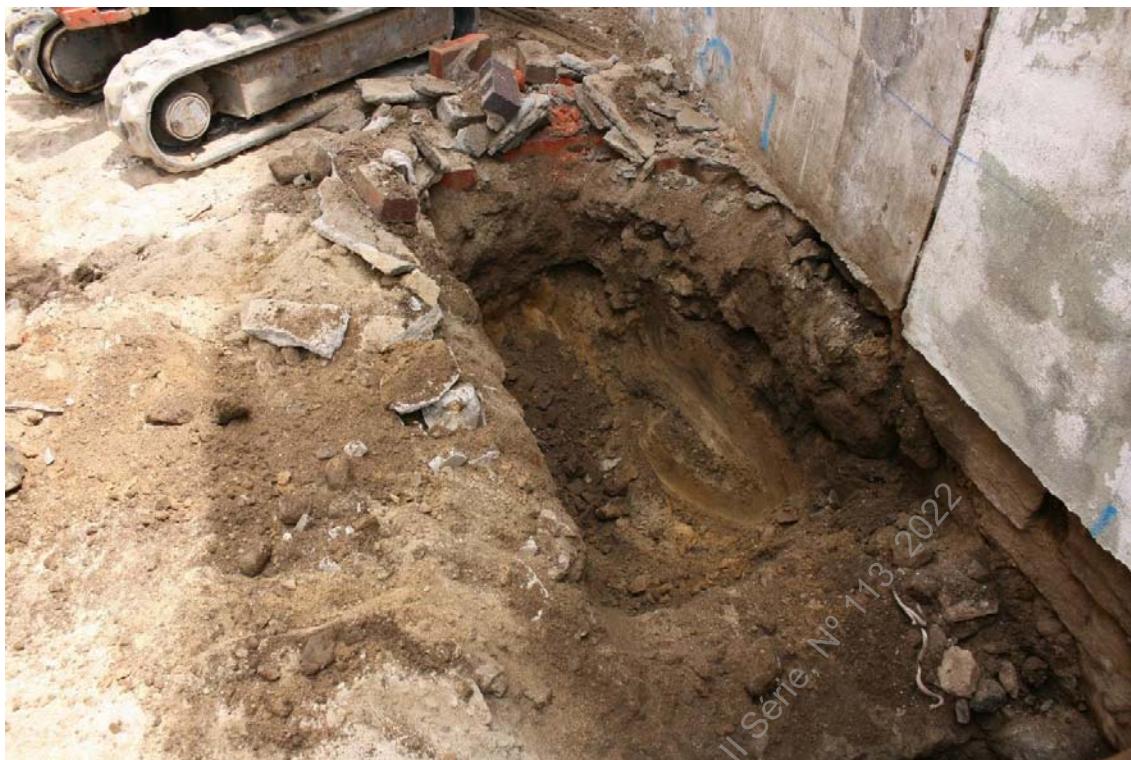
Foto 33 - (IMG_5236) – Aspeto de abertura de vala contígua a vala com empedrado.
