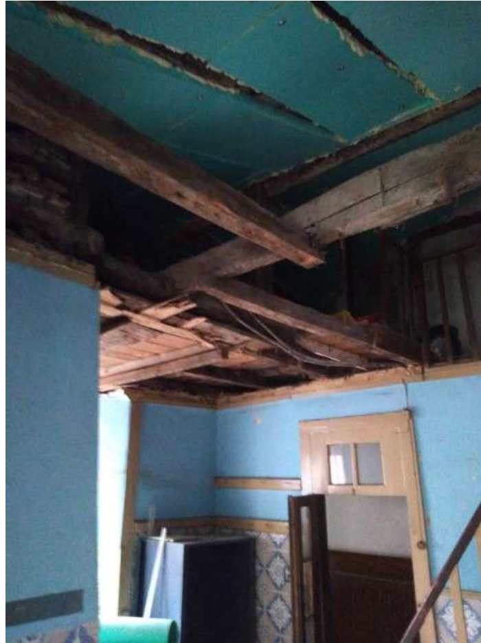
Figura 8 Teto da cozinha no segundo piso
