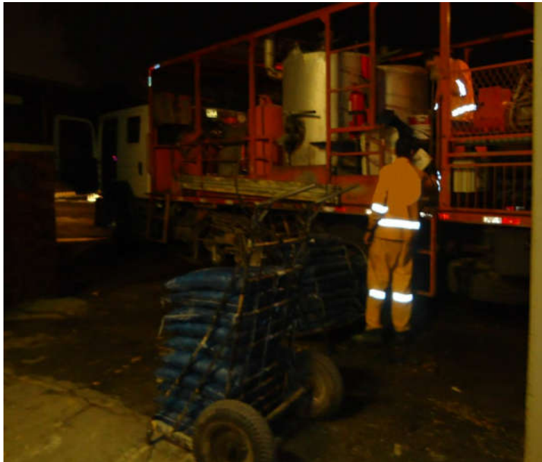
Figura 40 - Iluminação deficiente durante mobilização da equipe
