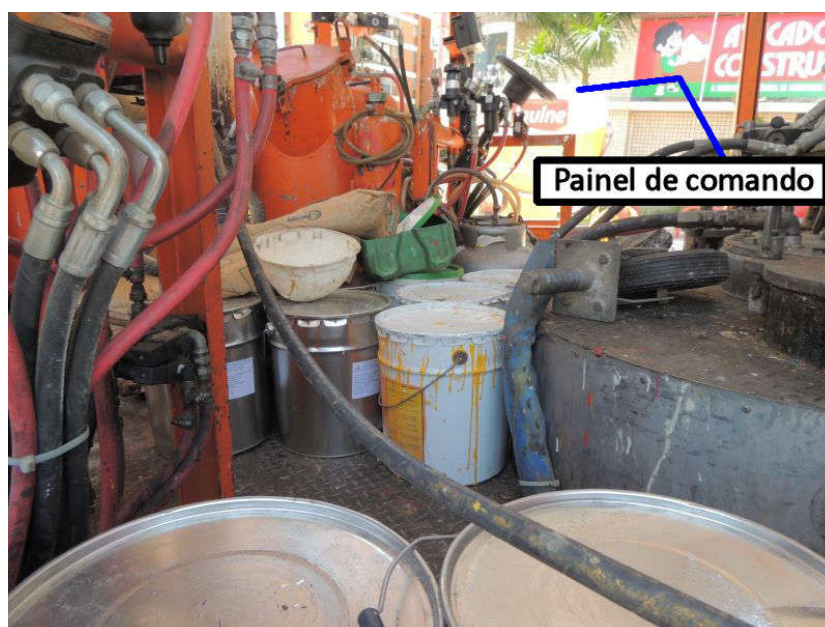
Figura 35 - Obstrução do acesso ao painel de comando
