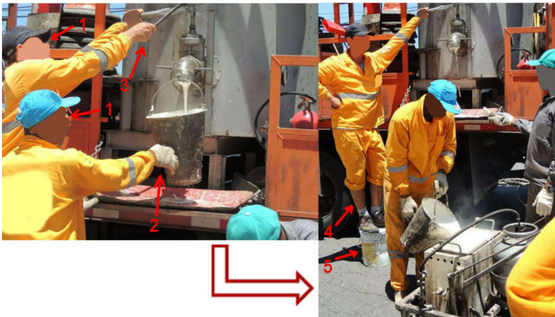
Figura 28 - Falhas no uso do EPI em sinalização viária com material quente (termoplástico)
