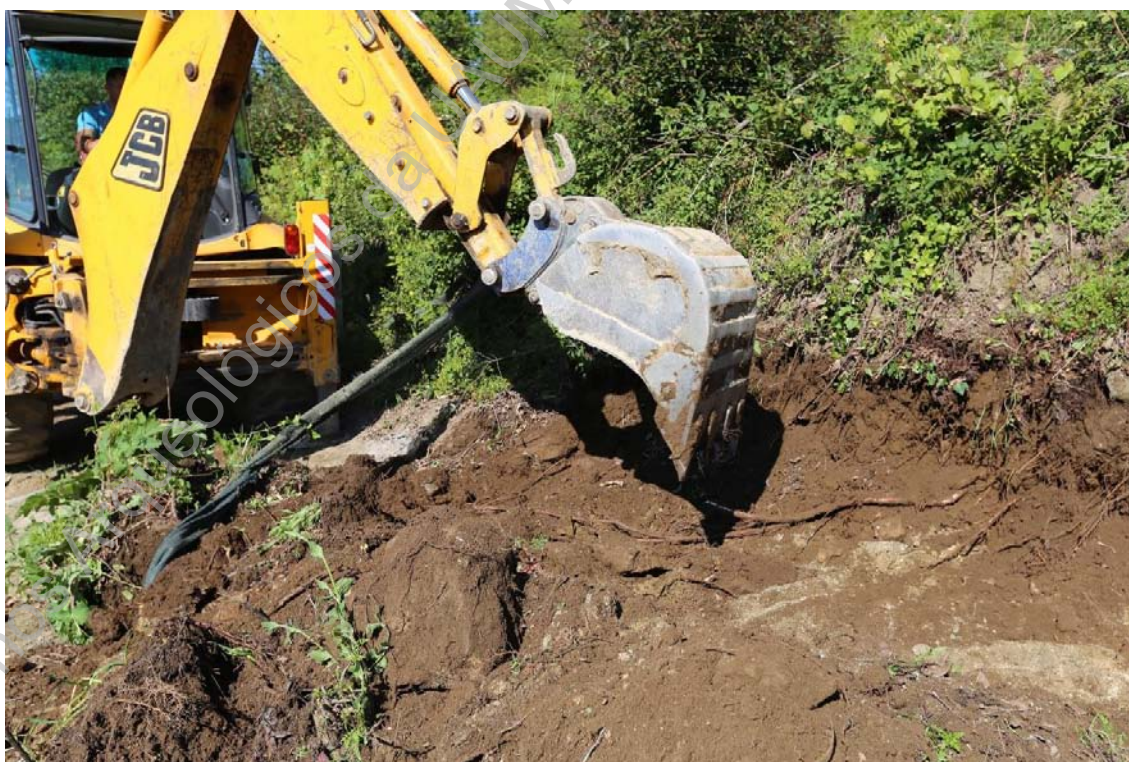
Foto 12 (IMG_0684) – Acompanhamento dos trabalhos de decapagem mecânica para criação de rampa de acesso da garagem.
