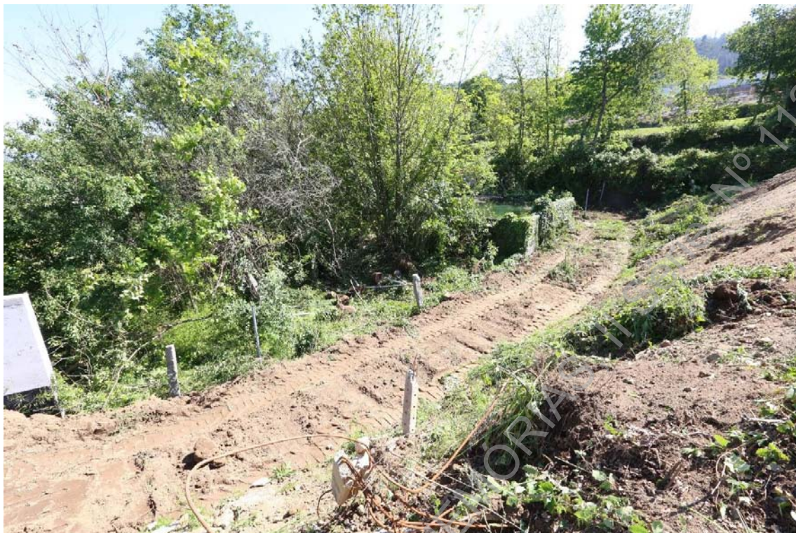
Foto 15 (IMG_1070) – Início dos trabalhos de limpeza para criação de vala de implantação do muro delimitador.
