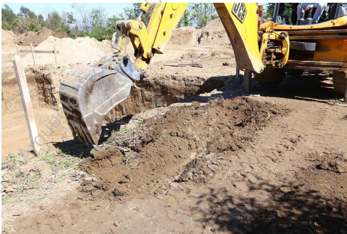
Foto 16 (IMG_1084) – Pormenor da abertura de rampa para acesso à área de garagem da habitação.
