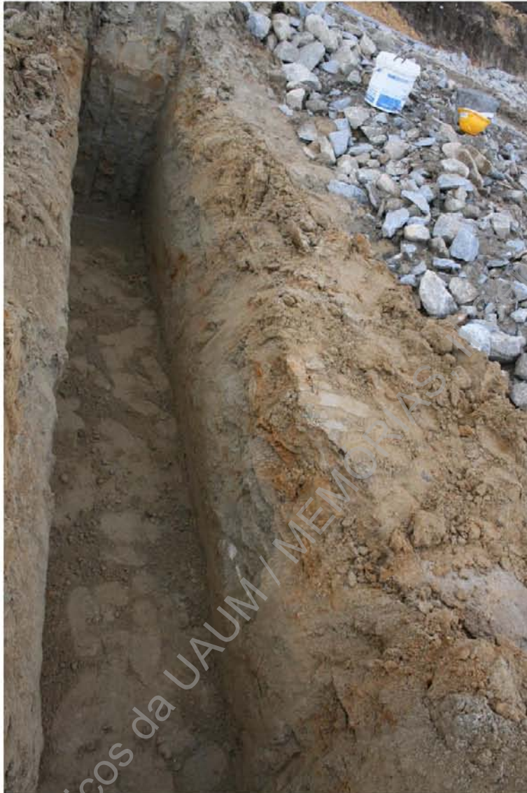
Foto 55 (IMG_9670) – Perspetiva final das valas para a implantação de estruturas de saneamento (S/N).
