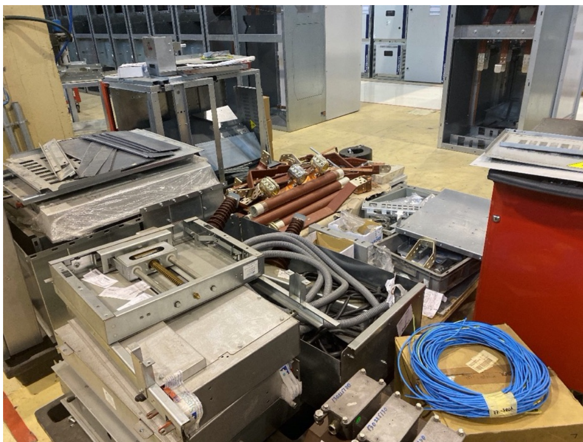
Figura 86 – Desorganização no gamba perto do local de trabalhos
