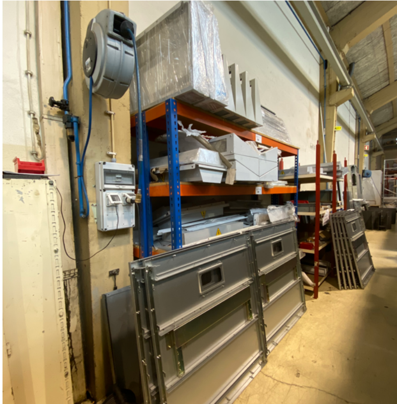
Figura 96 – Corredores de montagem obstruídos com material não identificado
