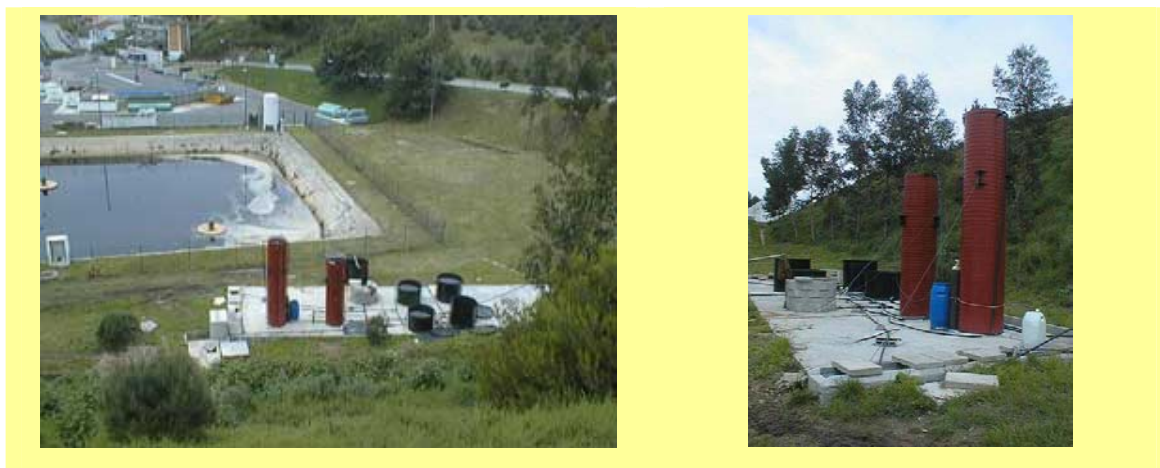
Figura 6.7 - ETL do aterro de Matosinhos e ETL-piloto
