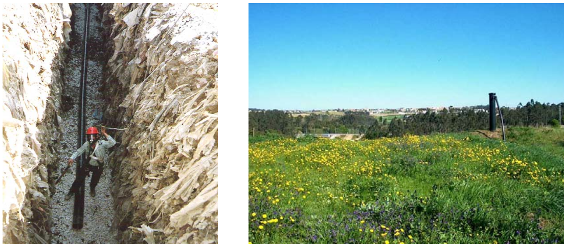
Figura 5.6 – Vala de desgaseificação da célula velha e topo da mesma célula depois da recuperação
