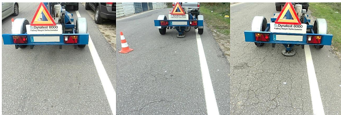
Figura 27 - Diferentes níveis de degradação visíveis na camada de desgaste do pavimento (local L5 na Rua de São Pedro)
