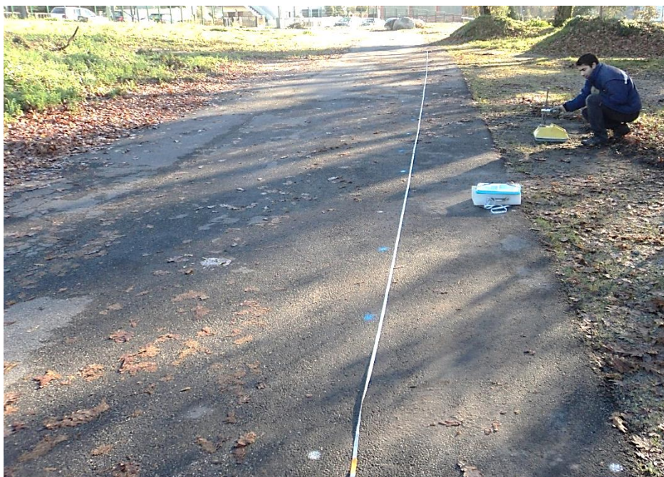
Figura 32 - Marcação de pontos de ensaio de deflexão espaçados de metro a metro (L1 -Caminho de acesso ao edifício do CVR)
