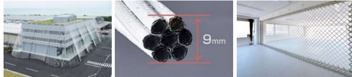
Figura 4.47. Edifício da empresa têxtil Komatsu Seiren no Japão, envolvido por centenas de cabos de fibra de carbono – Cabkoma – que no conjunto funcionam como um tecido, uma membrana, atuando como elemento de reforço sísmico (conceção arq. de Kengo Kuma) (Komatsu Matere, 2018).
