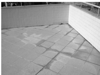
Figura 10: Acumulação de água em terraço
