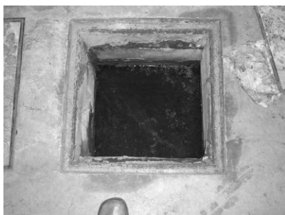
Figura 18: Depósito com águas freáticas
