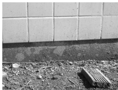
Figura 13: Deficiente impermeabilização de muro de cave.
