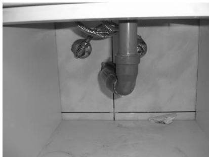
Figura 26: Inexistência de sifão em ramal de descarga de lavatório.
