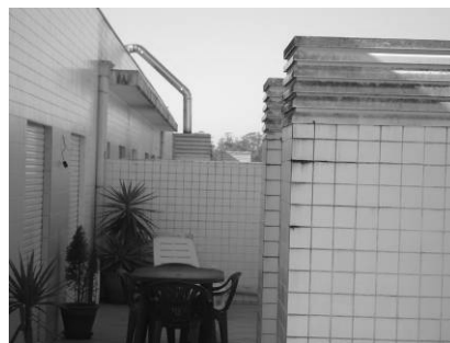
Figura 29: Altura não regulamentar das chaminés
