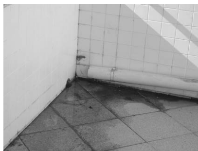
Figura 9: Tubo de queda com descarga em logradouro.
