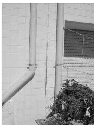
Figura 14: Destaque de material de uma junta de dilatação.
