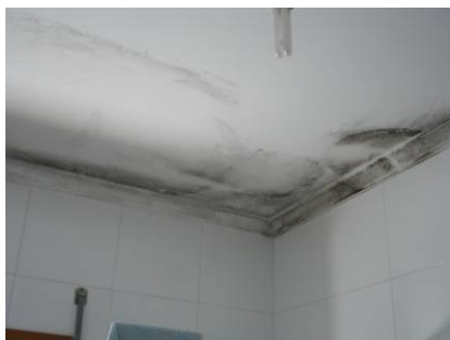
Figura 1: Mancha de humidade em tecto.
