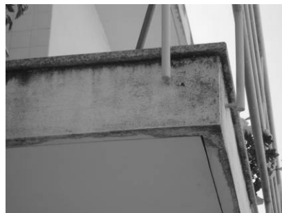
Figura 21: Inexistência de pingadeira em bordo de varanda.
