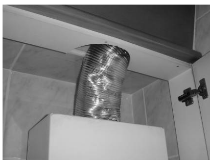
Figura 5: Redução de diâmetro na conduta de exaustão do esquentador.
