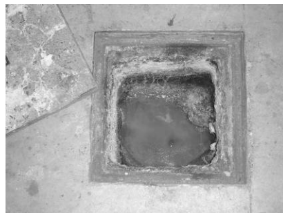
Figura 17: Caixas de visita parcialmente cheias.
