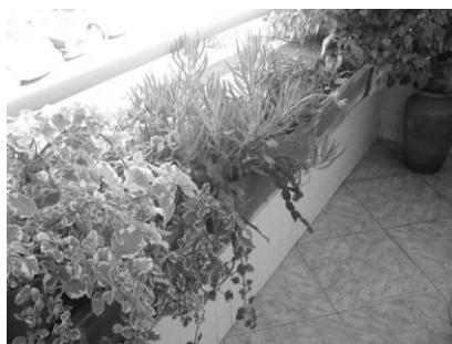
Figura 11: Varanda sem dispositivos de evacuação de água.
