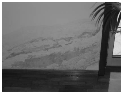
Figura 4: Mancha de humidade em parede junto ao vão exterior.
