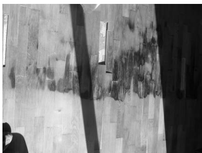
Figura 3: Mancha de humidade em pavimento.
