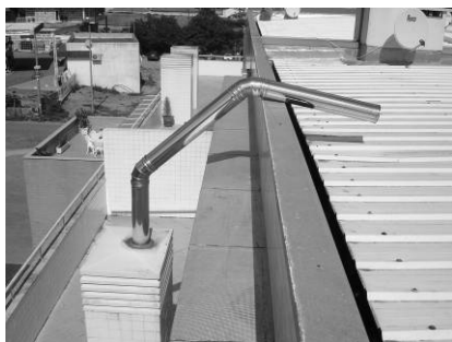
Figura 28: Prolongamento de conduta de fumos até a cobertura.
