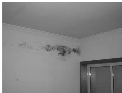
Figura 2: Mancha de humidade na parte superior de parede.
