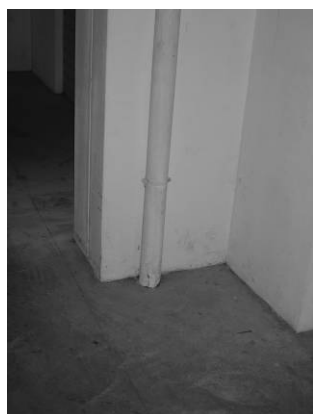
Figura 16: Inexistência de caixa de visita na inserção com o colector predial.
