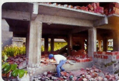
Figura 1 - Derrube e queda de paredes de alvenaria de enchimento devido ao efeito de um sismo
