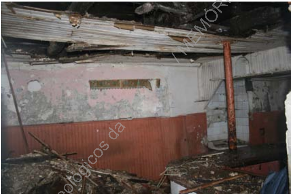
Foto 8 (IMG_7295) – Vista parcial de compartimento no rés-do-chão (NO/SE).
