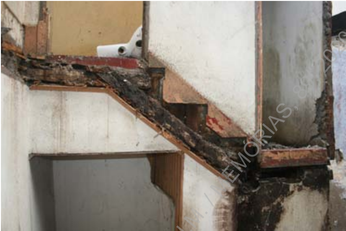
Foto 27 (IMG_7262) – Pormenor construtivo, aspeto de paramento após demolição de escadas de madeira (E/O).
