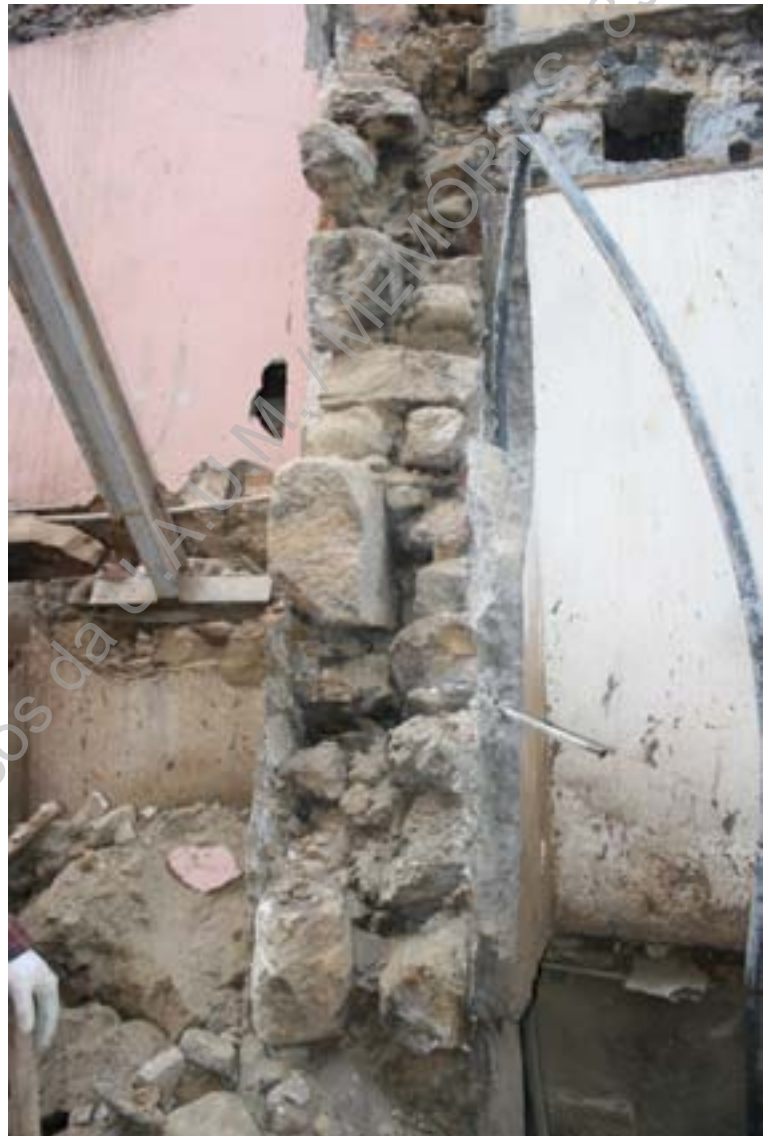
Foto 41 (IMG_7393) – Pormenor de parede em alvenaria parcialmente demolida (E/O).
