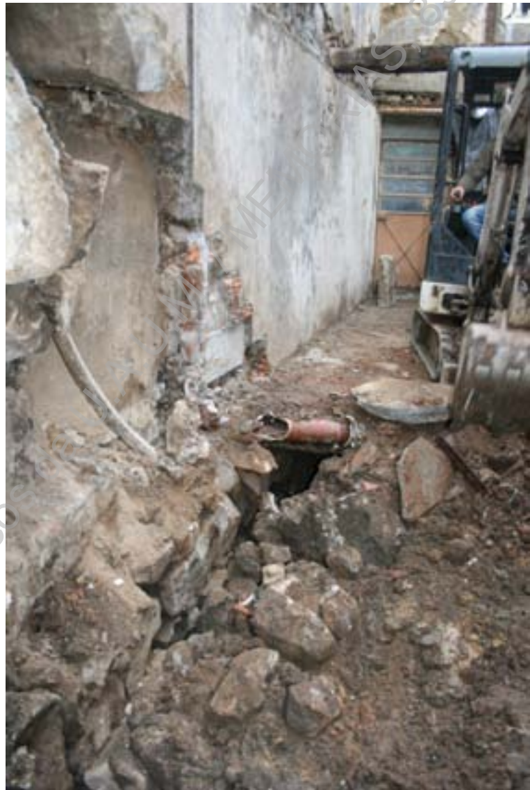
Foto 19 (IMG_7465) – Conduto de saneamento tipo aqueduto parcialmente desmantelada (NE/SO).
