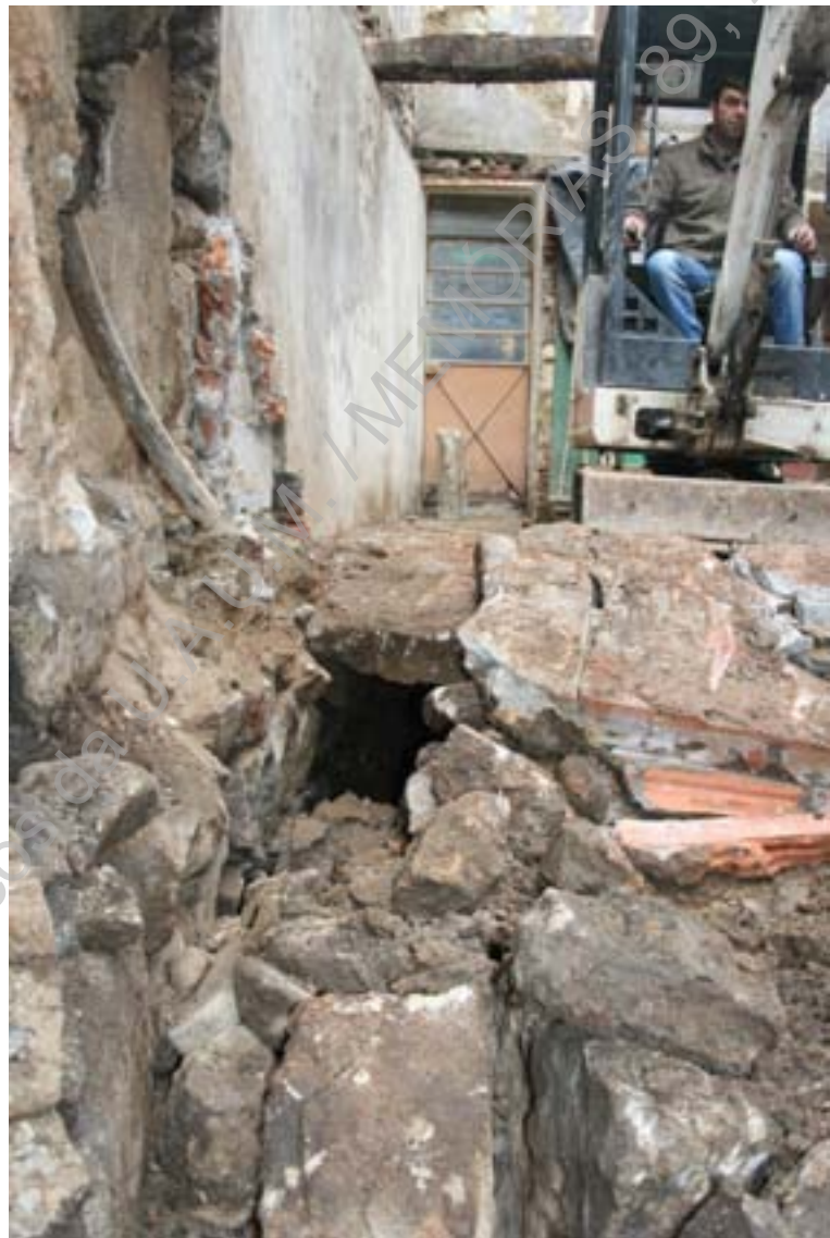
Foto 44 (IMG_7458) – Pormenor construtivo – conduta de saneamento parcialmente desmantelada (S/N).
