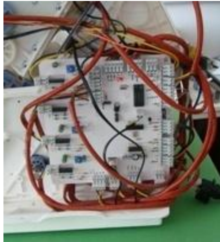
Figura 5-4: Vista frontal da placa de controlo dos motores e sensores
