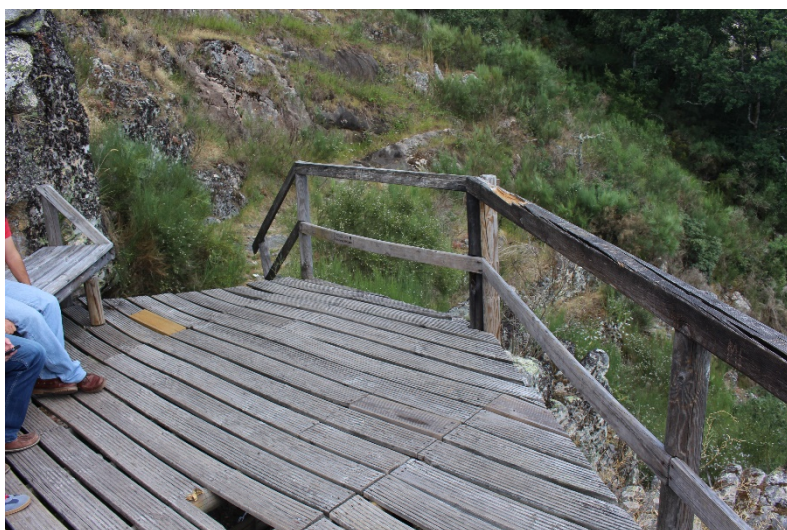
Figura 5.6: Plataforma no miradouro da cascata de Pitões das Júnias com sinais visíveis de degradação.
